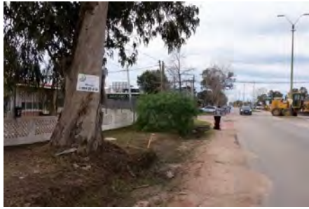
Conformación irregular de la vereda, cuneta y banquina.
