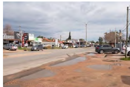
Zona de acceso vehicular a locales en balastro y sin resolución de drenajes pluviales.
